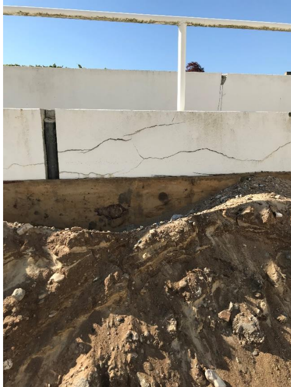
Frostskader på pudslag. Bemærk endvidere at fuger er revnede.
