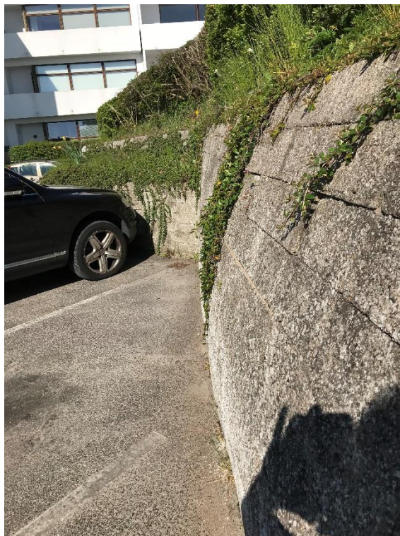
Muren på naboejendommen er blevet "tykmavet" grundet jordtrykket.
