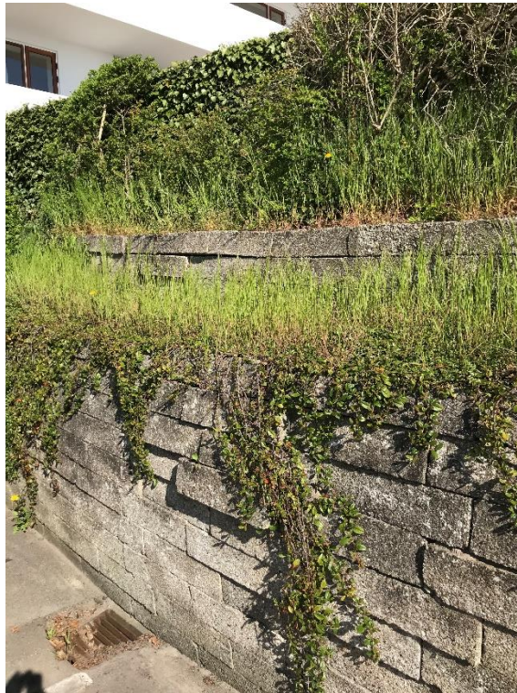
Jordtryk på støttemur på naboejendommen. Bemærk at betonblokkene bliver skudt ud, hvilket er et tegn på nedbrydning. Bemærk endvidere den lave støttemur tættere på skel.
