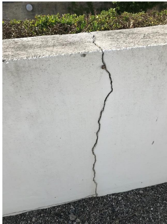
Sætningsskade, antageligt grundet udvaskning af jord under fundamentet.
