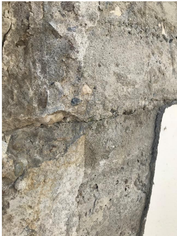
Pudslaget har sluppet betonoverfladen. Betonen er revnet vandret, hvilket muligvis et støbeskel.
