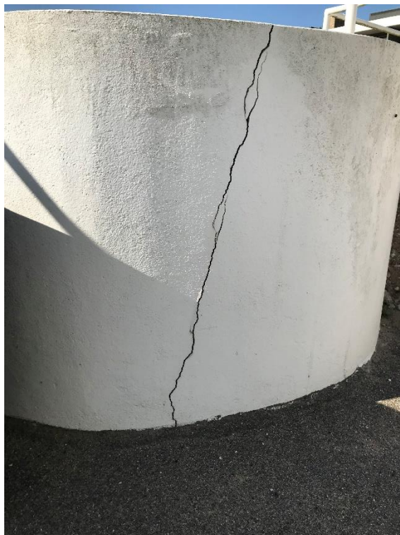
Revne i bue efter rodnet og frostskaade. Der har tidligere været beplantning i buerne.
