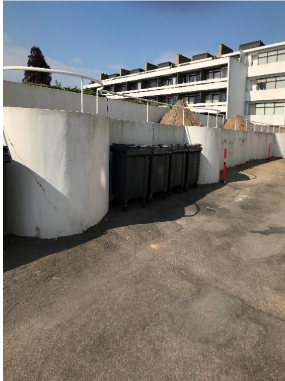
Revnedannelser ses generelt over alle støttemurenes overflader.
